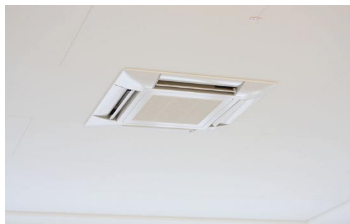
Die Blenden der Euro-rasterkassetten wurden in der Farbe Signalweiß lackiert, um diese architektonisch in die sensible Ecophon-Akustikdecke zu integrieren
